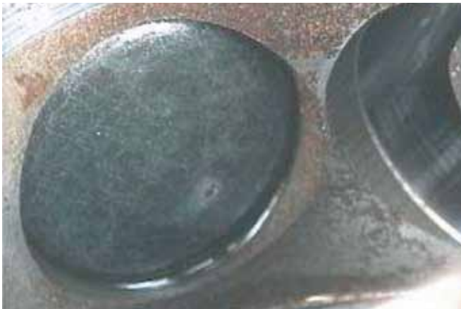
Korozija kućišta pumpe pod visokim pritiskom
